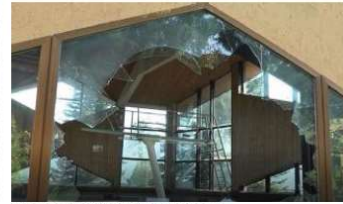
Una parte della vetrata della piscina in pezzi
